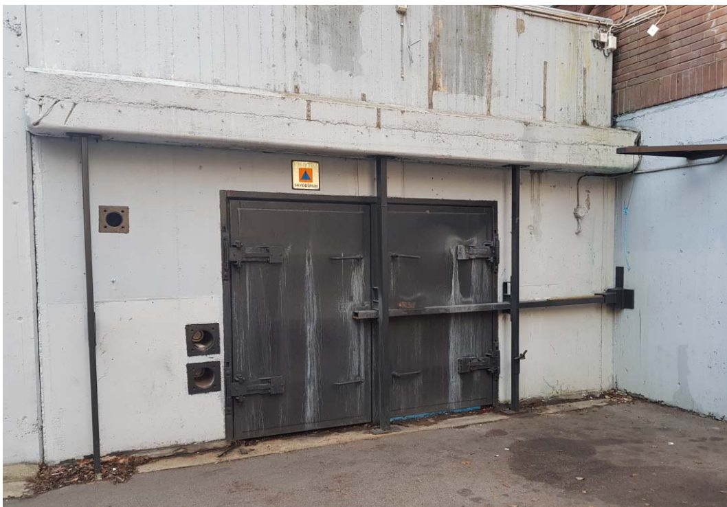
Ingång till skyddsrum, svårt att öppna dörrarna pga. ståpelare och balkar.
